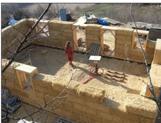
Figura 3: Detalle de proceso constructivo de formación de huecos mediante bastidores en muro de carga de aparejo (sin entramado).
