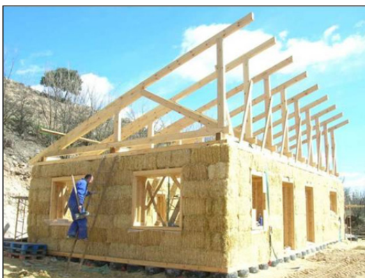
Figura 4: Detalle de proceso constructivo de estructura de cubierta sobre muros de carga.
